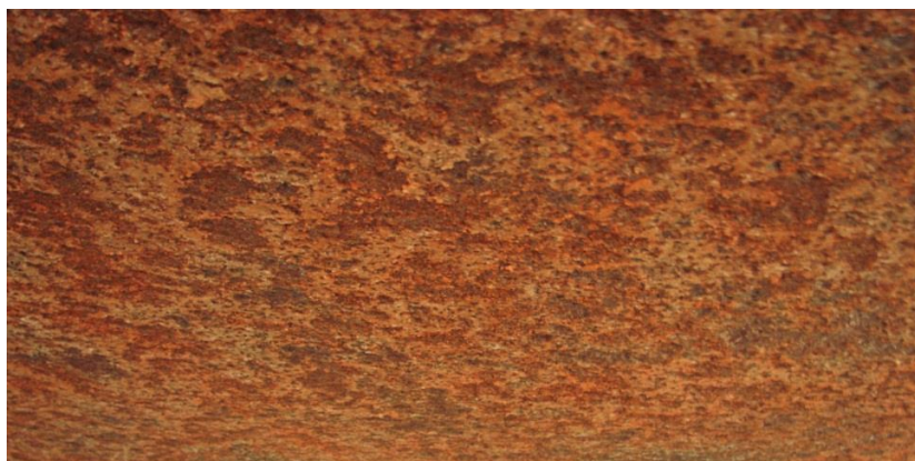
Рис. 2. Вид наружной обшивки днища большинства барж-площадок
